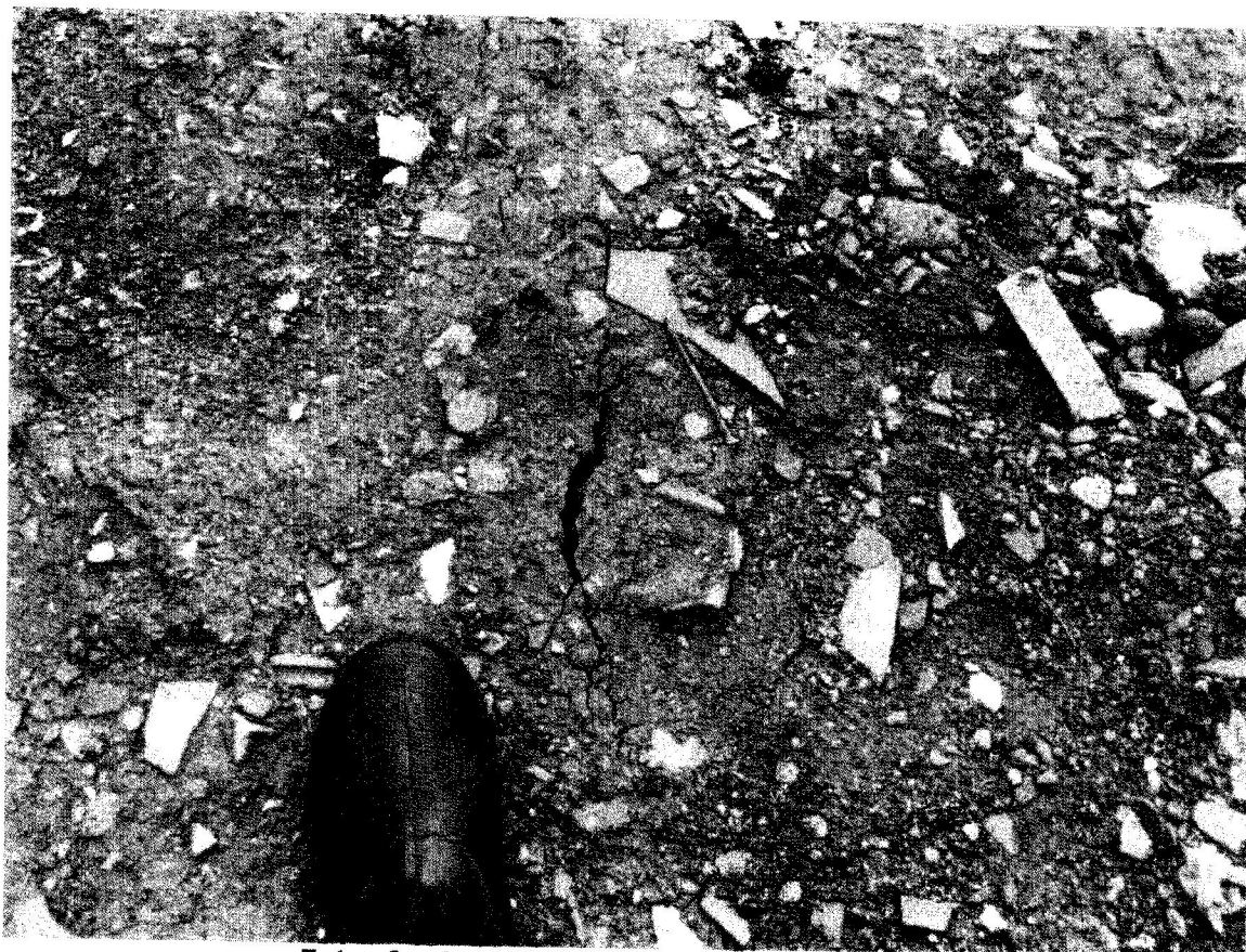
Fotos 3 e 4: Erosões e trincas na crista do talude.
