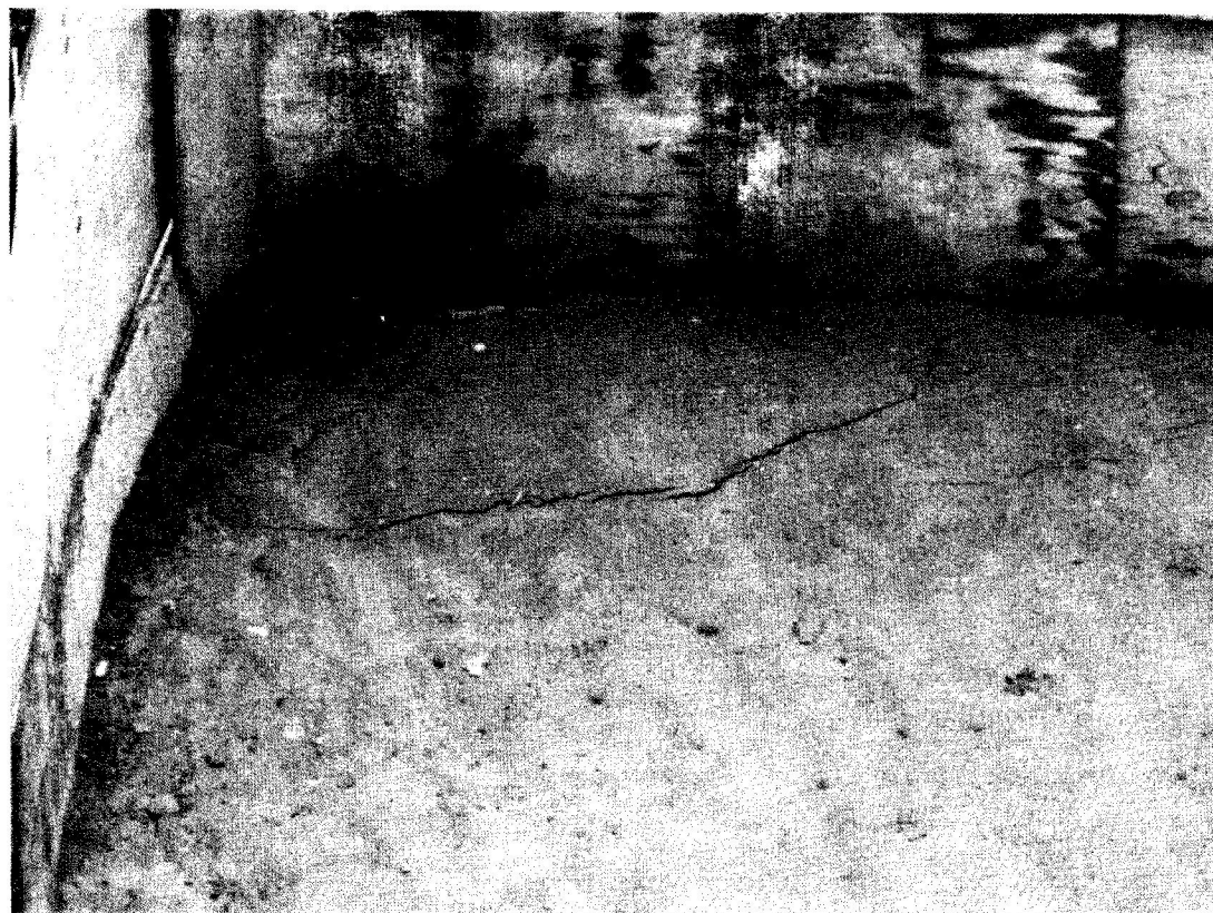
Foto 2: Trinca no solo, indicando a instabilidade do solo já existente no local.
